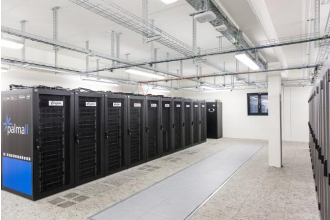
Ein Blick in den neuen Serverraum - links die Serverschränke mit PALMA II © WWU/Peter Leßmann
